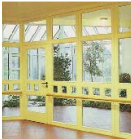
F-Verglasungen zwischen zwei Brandabschnitten (nur mit Genehmigung der Bauaufsicht)
